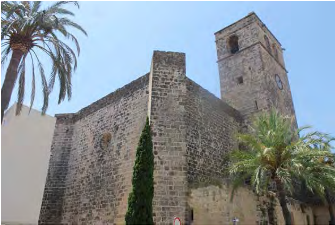
Fig. 2.- Cabecera de la iglesia de San Bartolomé de Jávea. (Fotografía del autor).
